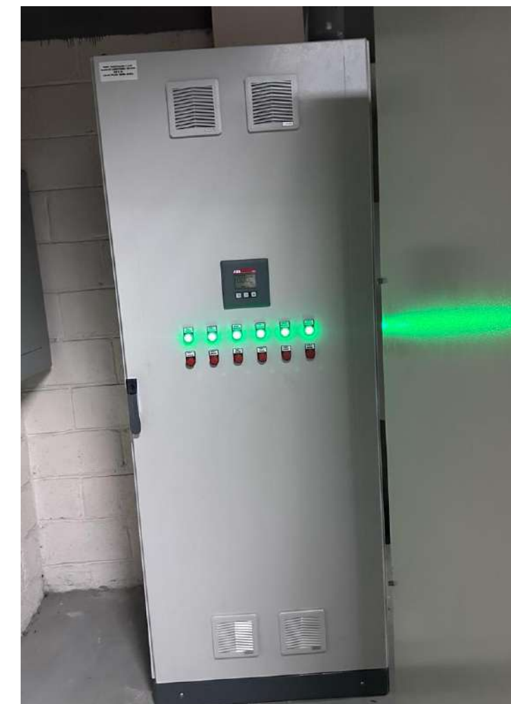
Banco de Capacitores
