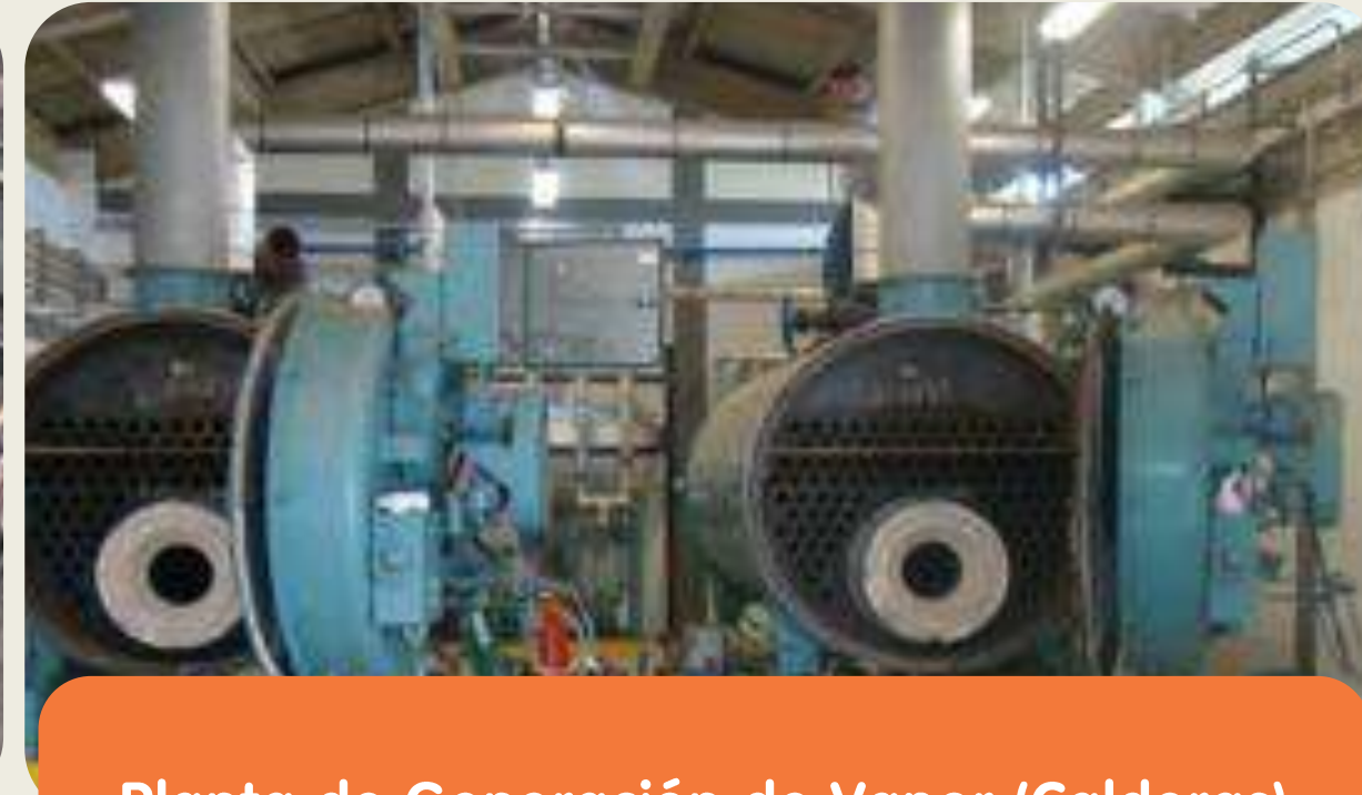
Planta de Generación de Vapor (Calderas)
