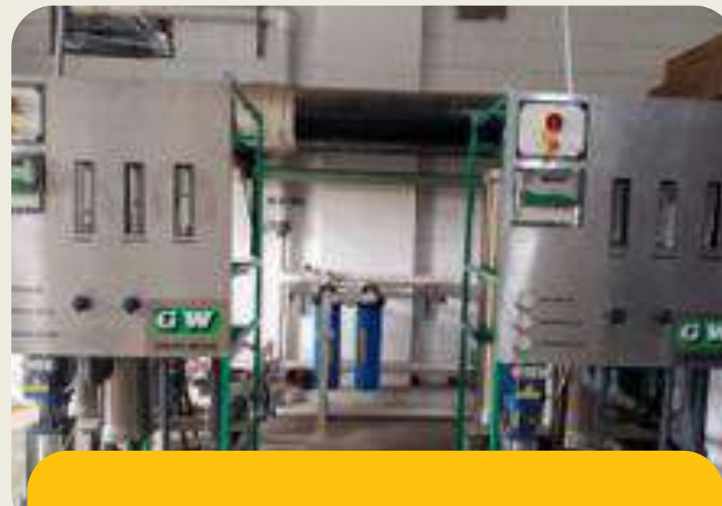
Planta de Ósmosis Inversa
