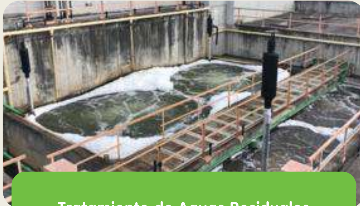
Tratamiento de Aguas Residuales
