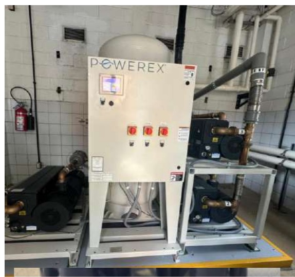
Cabezales de bombas de vacío
