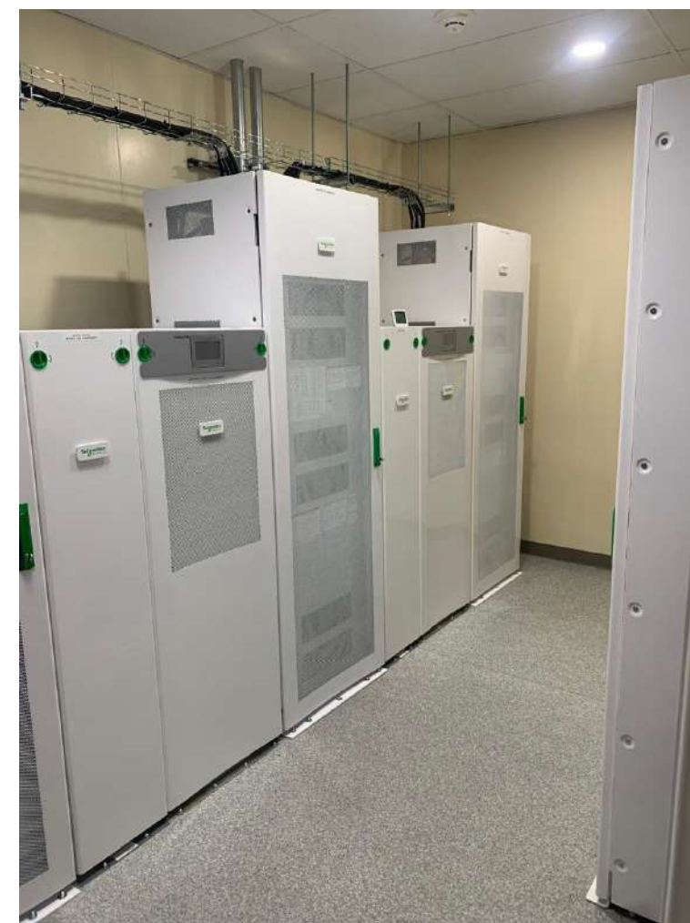
Sistema de Energía Ininterrumpida (UPS)
