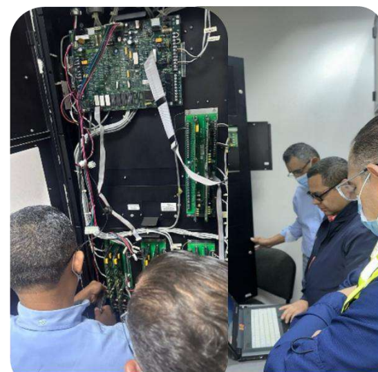
Sistema Contra Incendio
